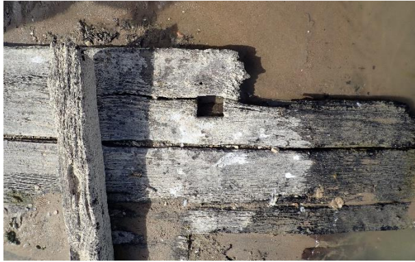
Afb. 21 Rechthoekig gat in huidgang GB (foto: J. van den Besselaar, MiM).
